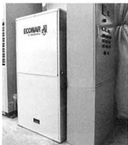
地中熱利用冷暖房 ヒートポンプと制御盤
